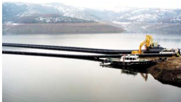
Трубопровід морського водовипуску DN/ID 1800 мм
