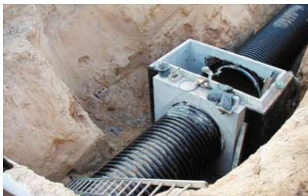
Колектор очисних споруд
