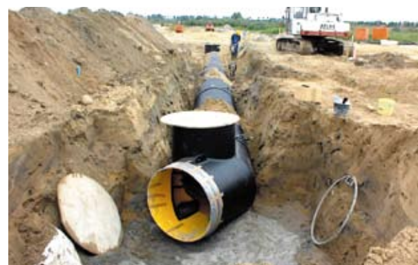
Водовід з відводом і колодязем
