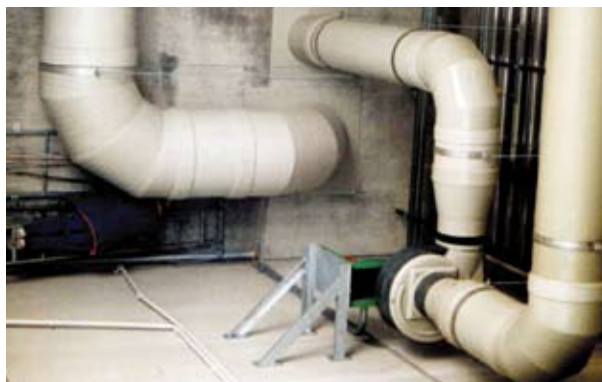
Труби промислової вентиляції
